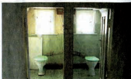
Doppel-Klo im Dachboden. Sanitäre Einrichtungen in der Matrosenkaserne.
