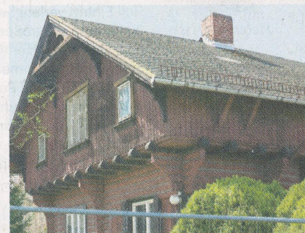
Die Sanierung der Matrosenhäuser ist komplizierter als erwartet.
